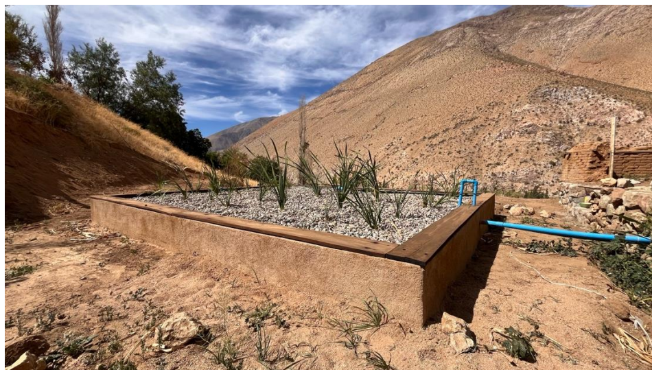
Humedal Construido con aireación mecánica - Región de Coquimbo, Chile
